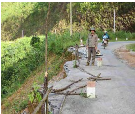
Hình 46: Sạt lở taluy âm trên đường tỉnh lộ 108, vết lộ SL.100 066 MB khu vực xã Cò Mạ, Thuận Châu, Sơn La.
