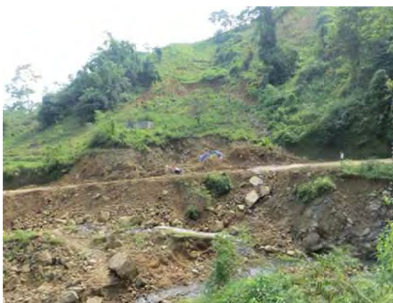
Hình 20: Trượt lở gây sạt đường giao thông tại vết lộ SL.102 561 MB khu vực xã Tô Múa, tỉnh lộ Mộc Châu - Tô Múa.
