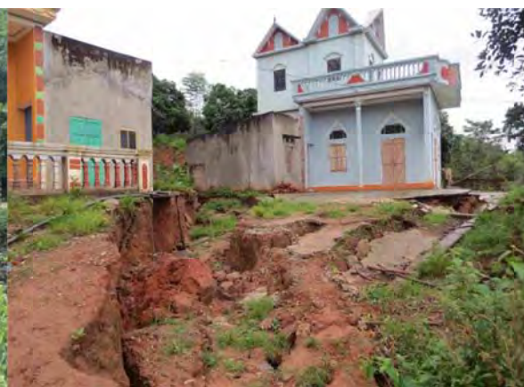
Hình 21: Trượt lở gây nứt, sập nhà dân tại vết lộ SL.102 576 MB khu vực xã Mường San, Mộc Châu, Sơn La.
