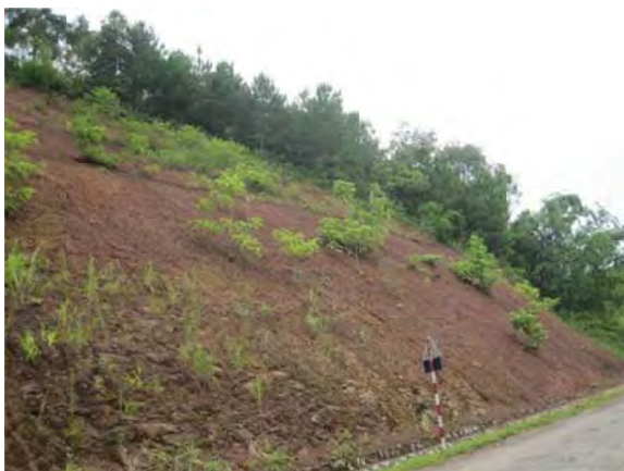
Hình 40: Trượt lở trong đới PH hoàn mạnh tại vết lộ SL.113 022 MB khu vực tổ 9 phường Tô Hiệu.
