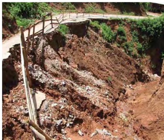
Hình 47: Sạt lở taluy âm trên đường liên xã, vết lộ SL100 425MB khu vực xã Chiềng Bôm, Thuận Châu, Sơn La
